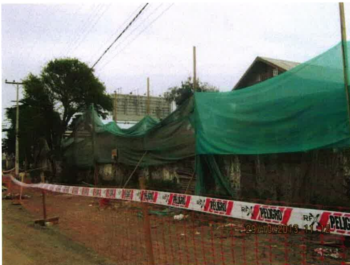
Foto 7: Falta de mantención de los cierros dispuestos.
