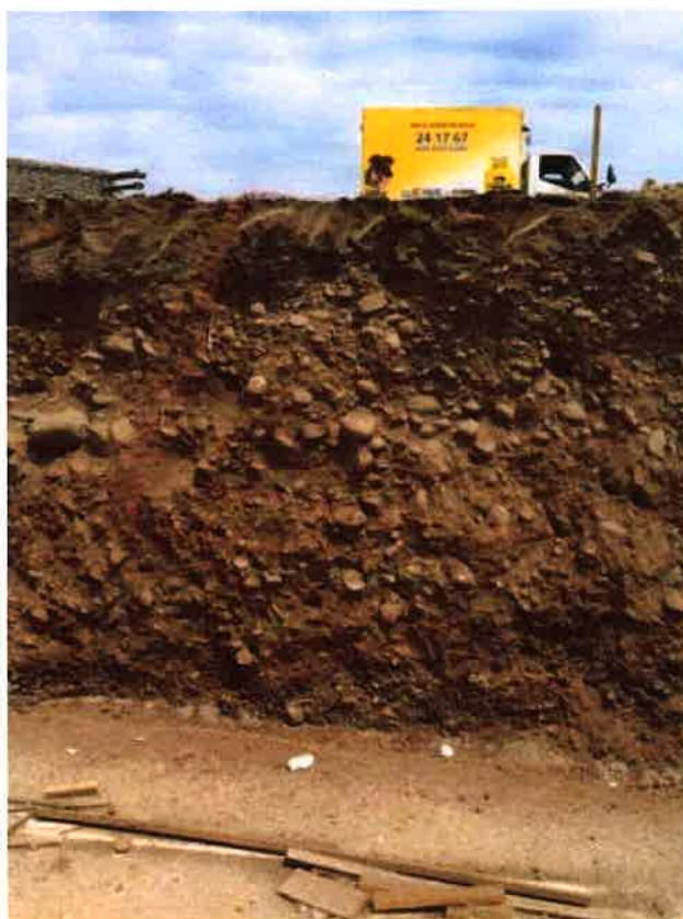
Foto 17: Excavaciones profundas sin protecciones
