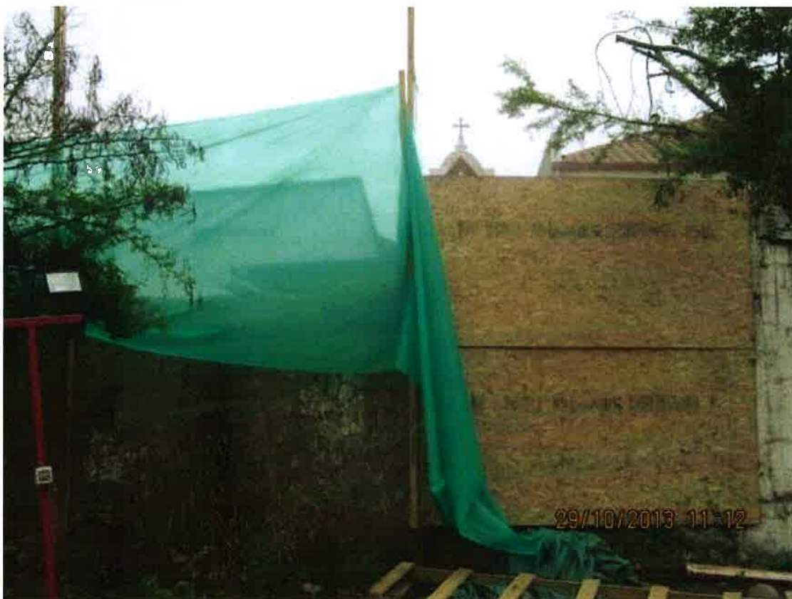
Foto 6: Ejecución de cierros provisionales que no se ajusta a lo especificado
