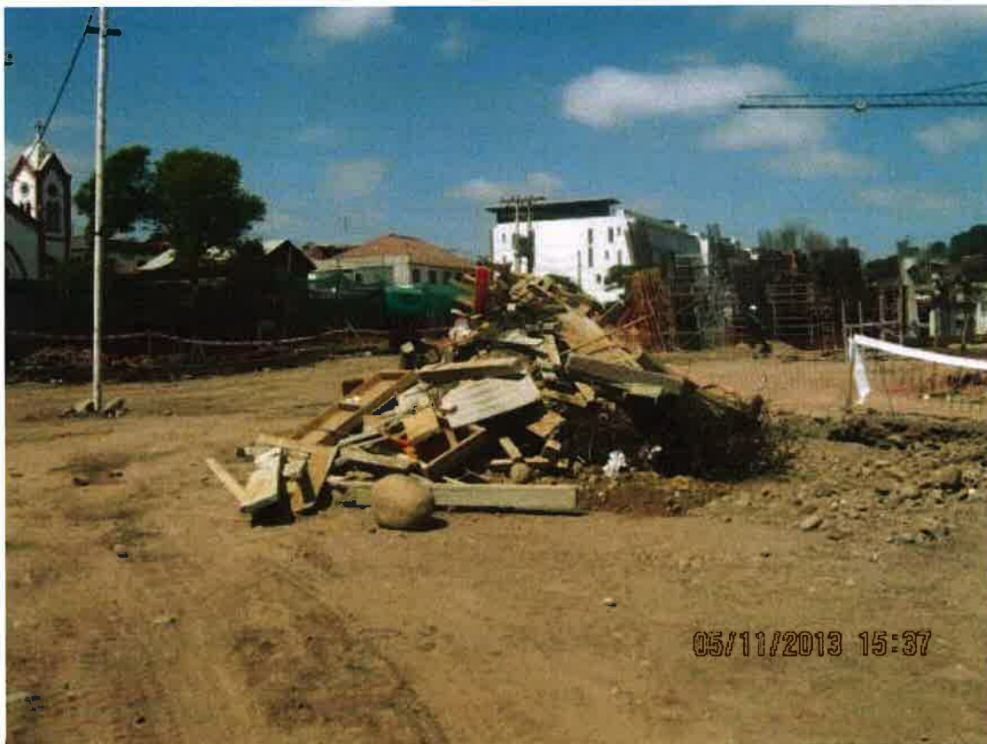
Foto 10: Zona de escombros que deben ser retirados en sector norponiente
