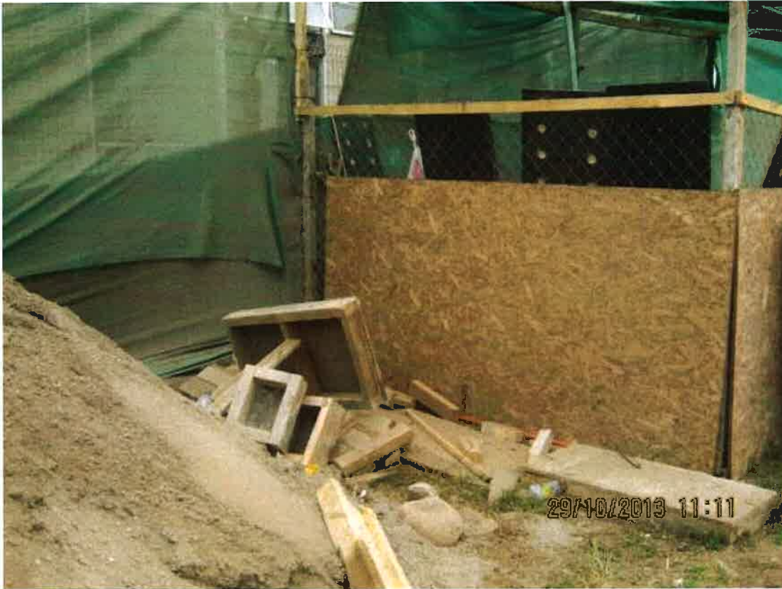
Foto 9: Zona de escombros en sector de talleres
