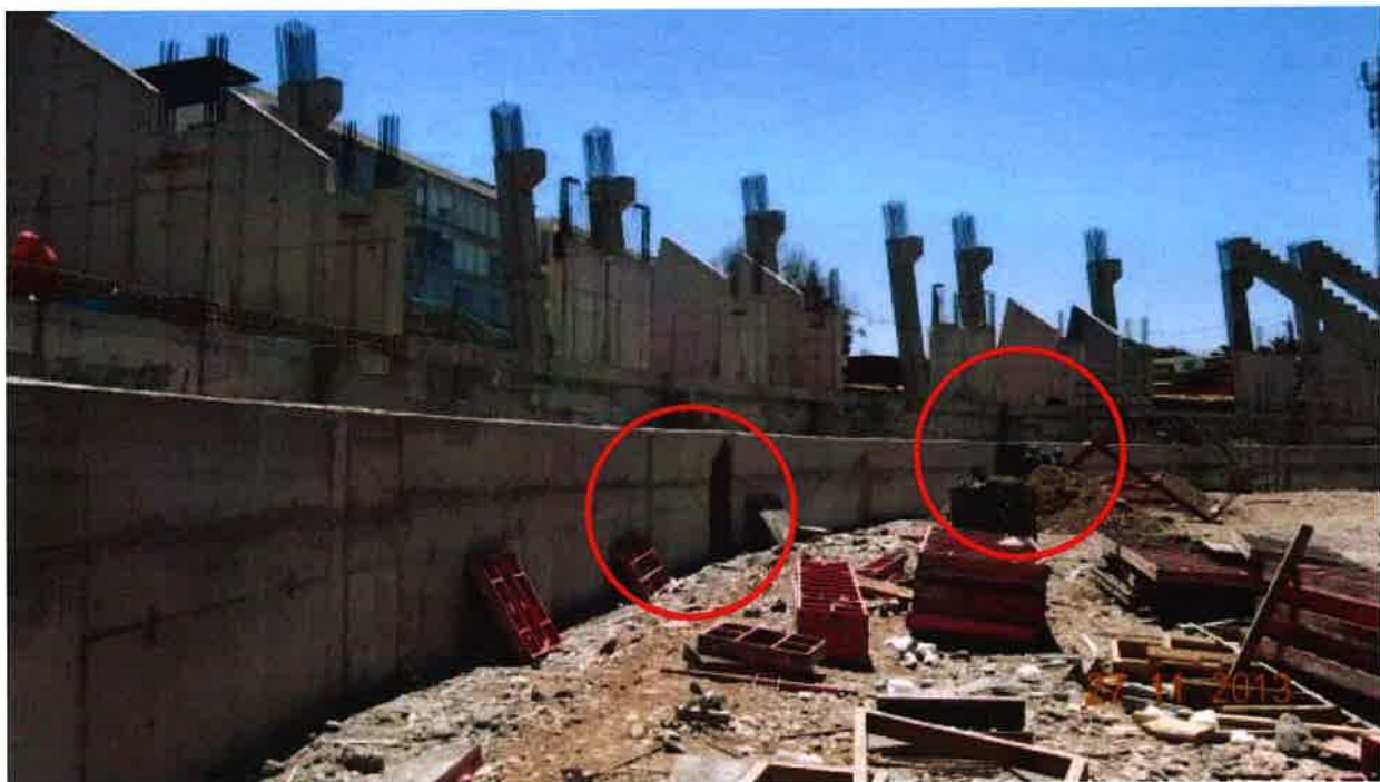
Foto 4: Muro cancha sector norte con 2 secciones que presentan deficiencias en la ejecución.
