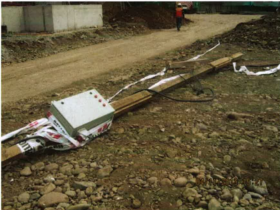
Foto 14: Tablero eléctrico en el suelo sin advertencia que indique si está operativo
