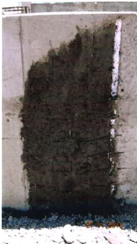
Foto 5: Armadura deficiente en sección de muro cancha
