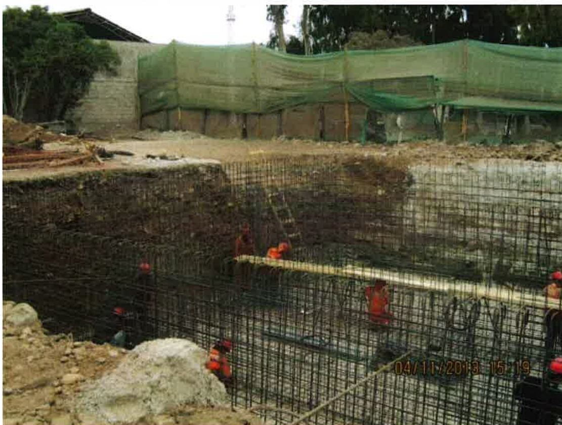
Foto 18: No se observan demarcaciones o perímetros de seguridad en las excavaciones profundas
