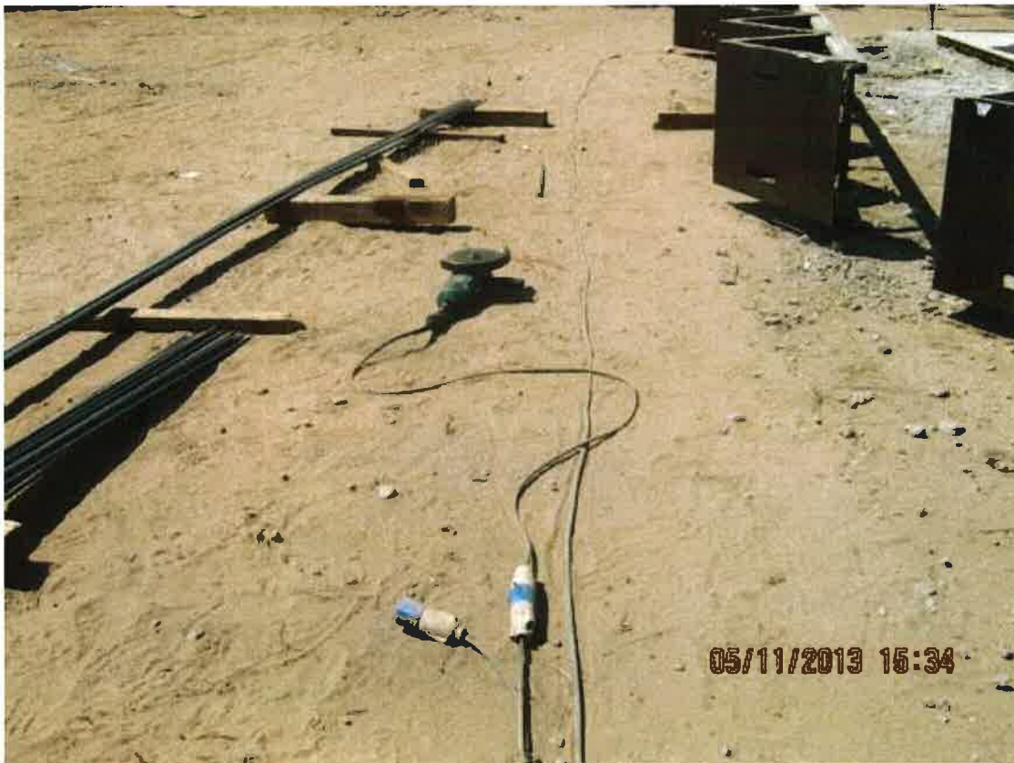
Foto 16: Conductores a ras de piso sin condiciones que adviertan su presencia
