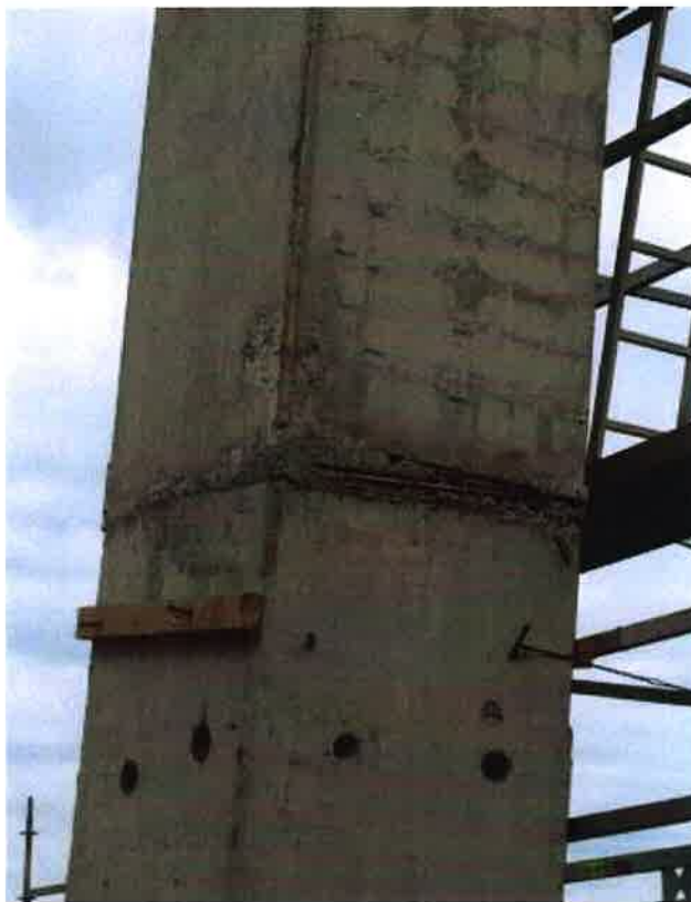
Foto 1: Enfierradura a la vista en pilar ya hormigonado.
