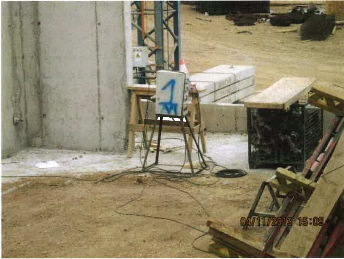
Foto 15: Tablero alimentador con todos sus conductores a ras de suelo
