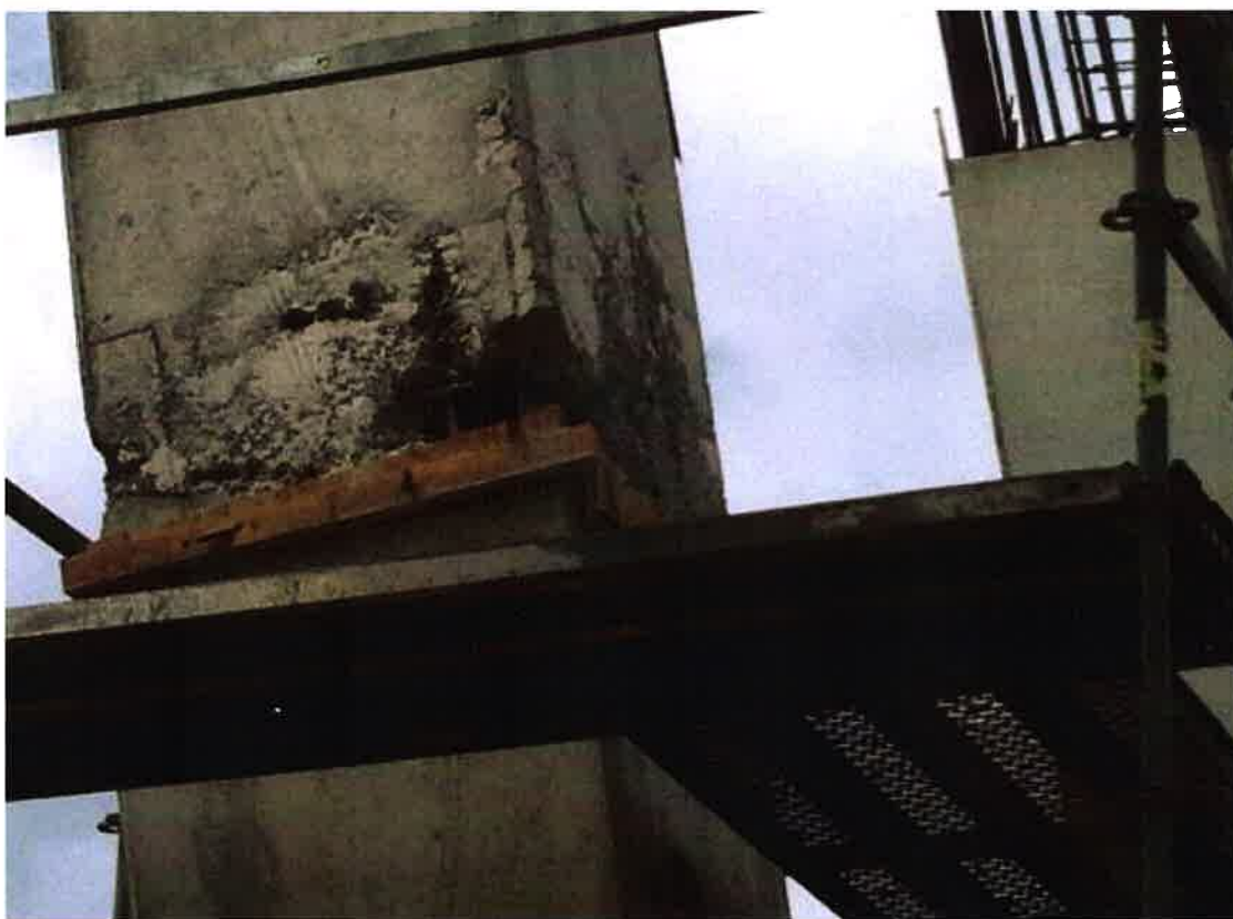
Foto 2: Ejemplo de encuentro entre hormigón viejo y nuevo defectuoso en pilar
