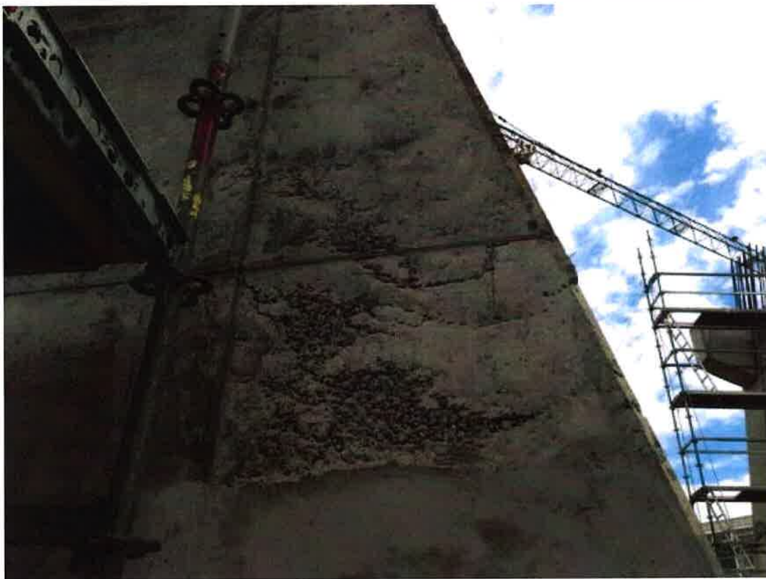
Foto 3: Ejemplo de nidos en muros bajo graderías
