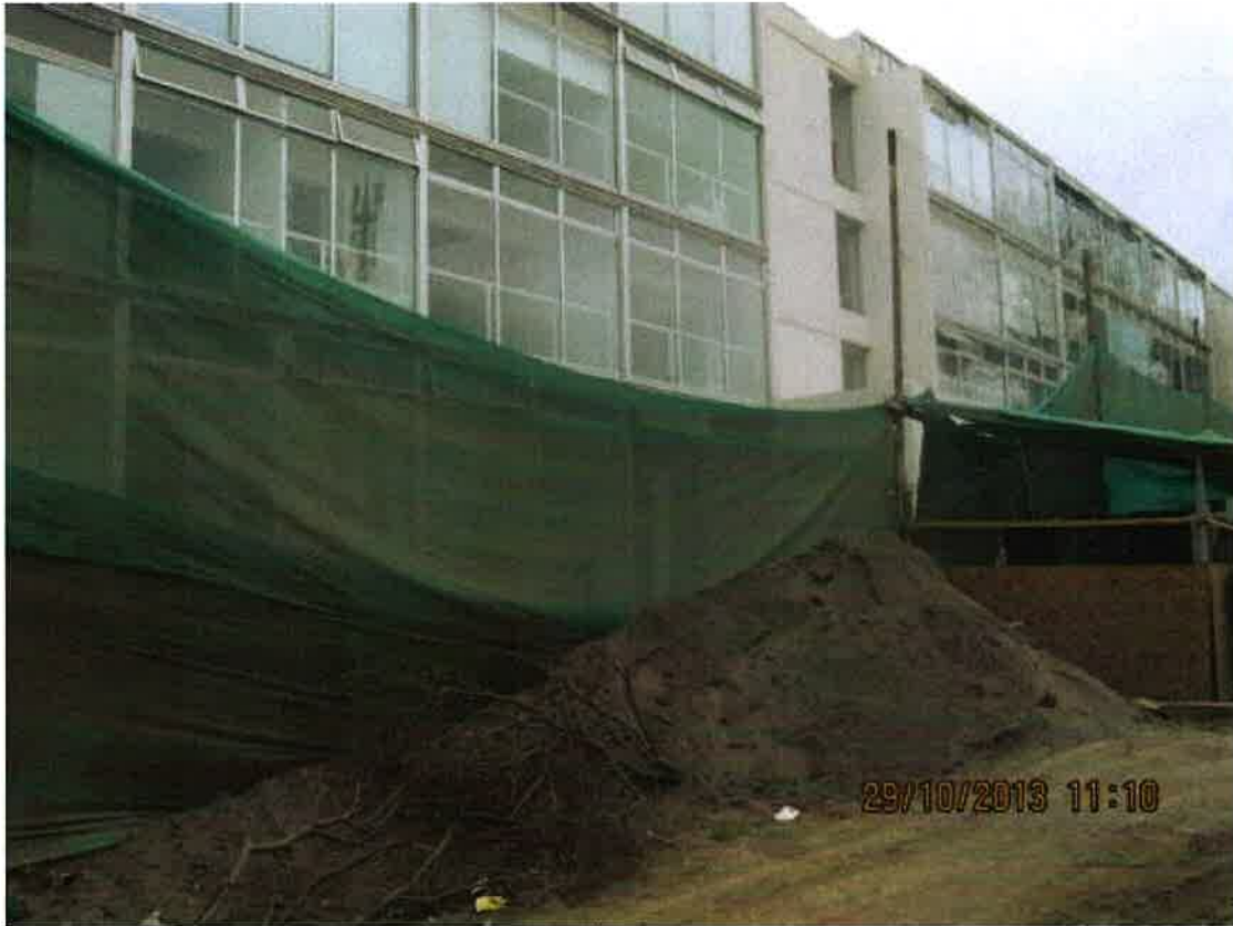
Foto 13: Cierros de malla raschel que debieran cumplir con las condiciones contra impacto por ruido por cercanía a sector habitado
