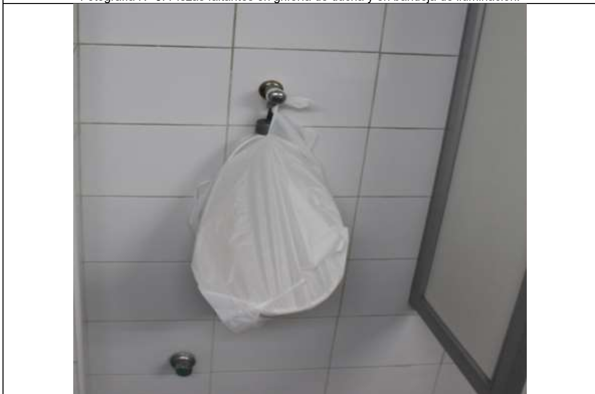
Fotografía N° 4. Urinario en sector baño varones para el personal de la empresa se encuentra inoperativo.
