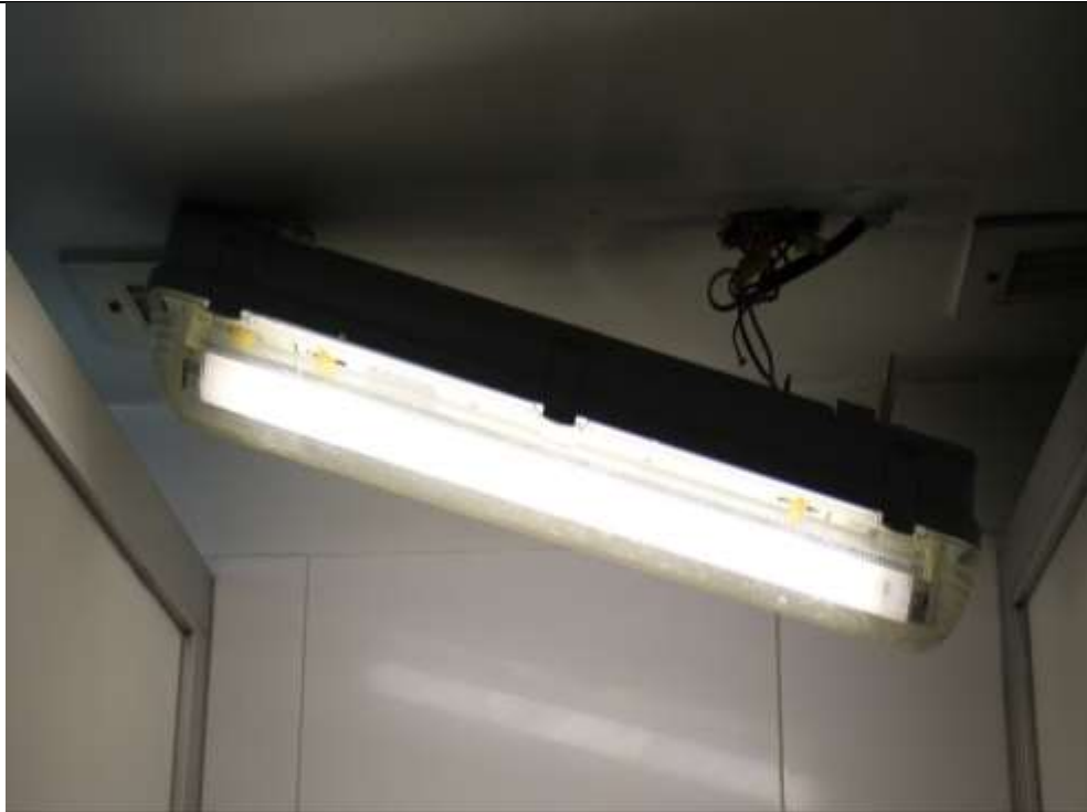
Fotografía N° 7. Baño damas para clientes. Luminaria desprendida en sector nicho de WC.
