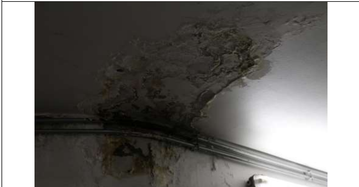
Fotografía N° 12. Zona de encuentro cielo muro de hormigón armado dañado y con presencia de corrosión y humedad, en sector de estacionamiento N° 141.
