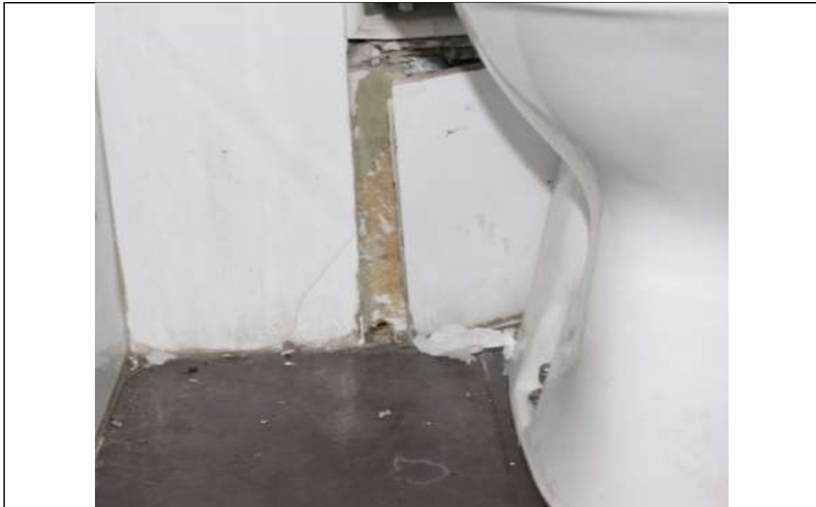
Fotografía N° 9. Baño varones para clientes. Pieza de cerámica desprendida en sector viga falsa inferior.
