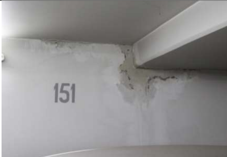
Fotografía N° 14. Revestimiento de zona de encuentro cielo muro de hormigón armado dañado y con presencia de humedad, en sector de estacionamiento N° 151.
