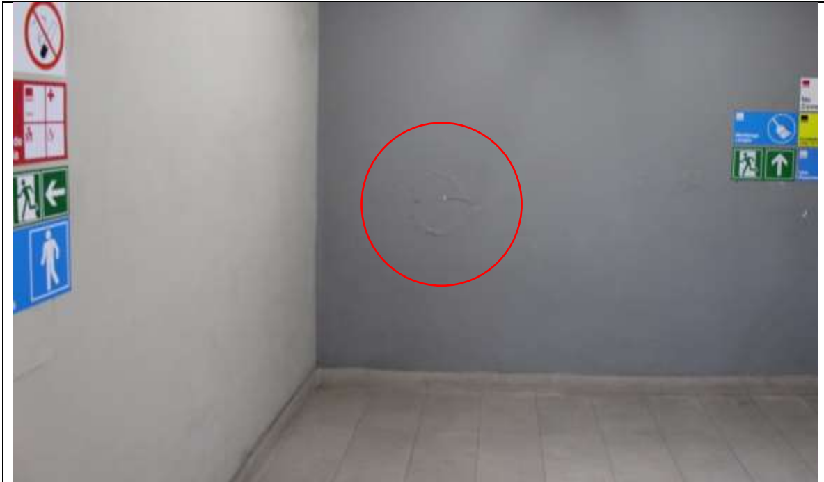
Fotografía N° 1. Englobamiento del revestimiento de pintura en el sector de descanso de la escalera subterránea frente a las oficinas de la concesionaria.
