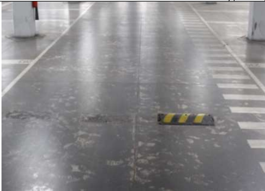
Fotografía N° 22. Resaltos ubicados entre estacionamientos N° 235 y 283 faltantes.
