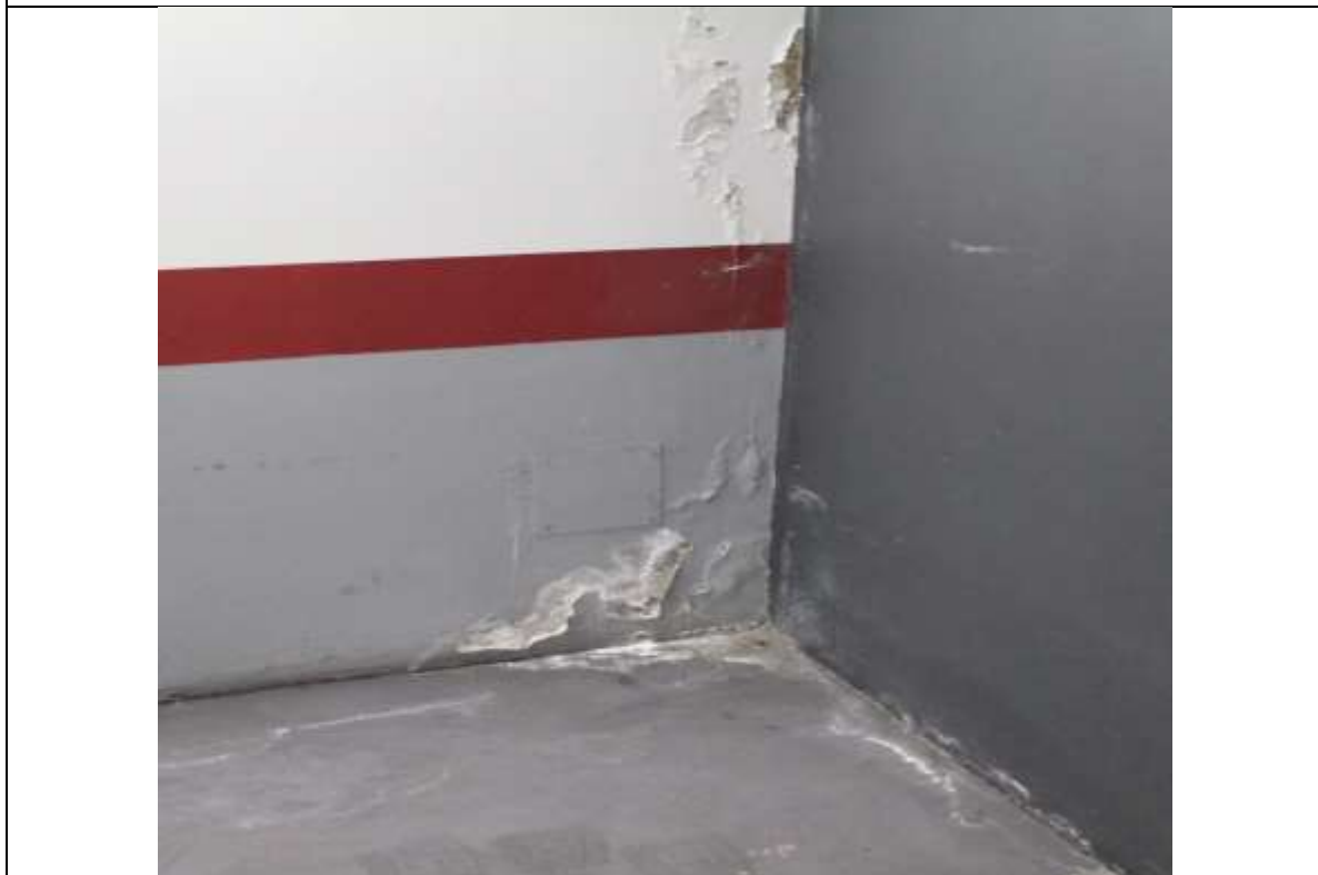
Fotografía N° 10. Presencia de humedad en muros de hormigón y losa, con daño del revestimiento de pintura. Sector estacionamiento N° 364.
