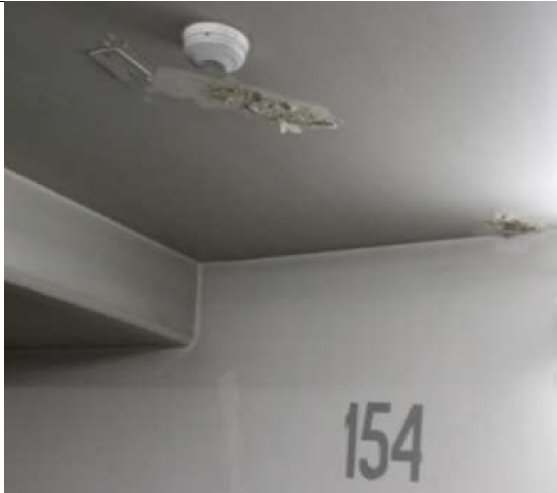
Fotografía N° 17. Revestimiento de losa de hormigón armado dañado y con presencia de humedad, en sector de estacionamiento N° 154.
