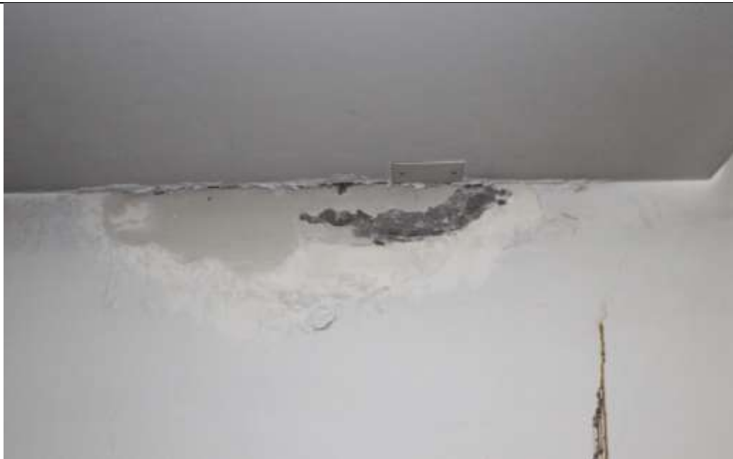
Fotografía N° 15. Revestimiento de zona de encuentro viga muro de hormigón armado dañado y con presencia de humedad, en sector de estacionamiento N° 152.
