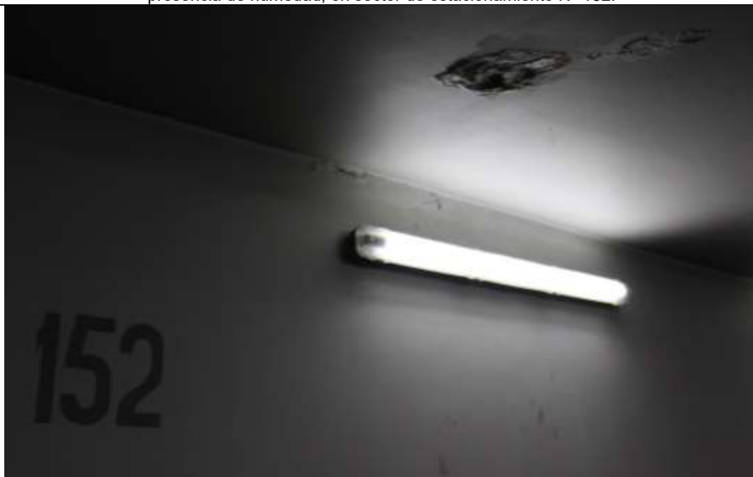
Fotografía N° 16. Revestimiento de losa de hormigón armado dañado y con presencia de humedad, en sector de estacionamiento N° 152.
