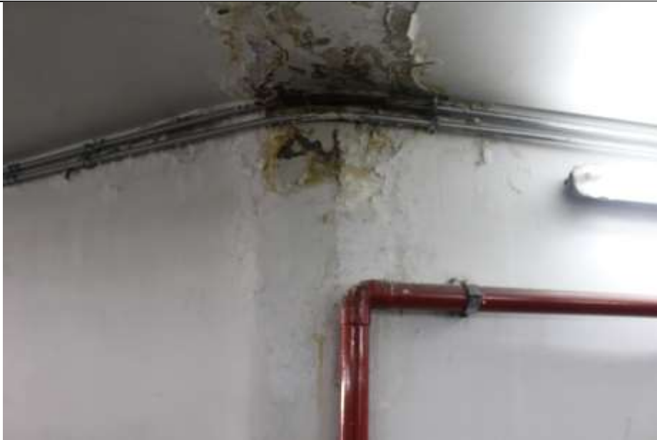
Fotografía N° 13. Zona de encuentro cielo muro de hormigón armado dañado y con presencia de corrosión y humedad, en sector de estacionamiento N° 141.
