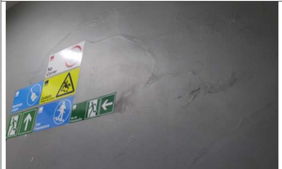
Fotografía N° 2. Englobamiento del revestimiento de pintura en el sector escalera subterránea frente a las oficinas de la concesionaria.
