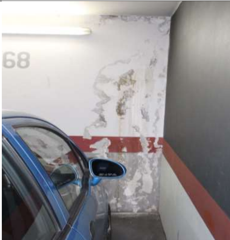
Fotografía N° 18. Revestimiento de muro de hormigón armado dañado, en sector de estacionamiento N° 168.
