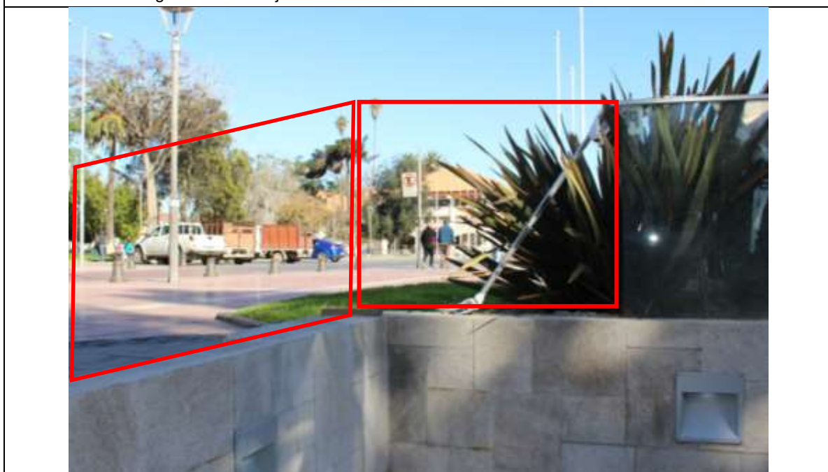
Fotografía N° 24. Piezas faltantes de baranda de protección de la caja escala del acceso peatonal oriente del edificio.
