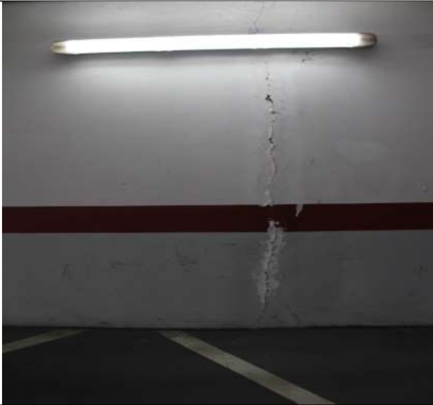
Fotografía N° 19. Existencia de fisura de cielo a piso con prolongación hacia la losa de hormigón, en el sector entre el estacionamiento N° 141 y el pórtico de acceso al estacionamiento.
