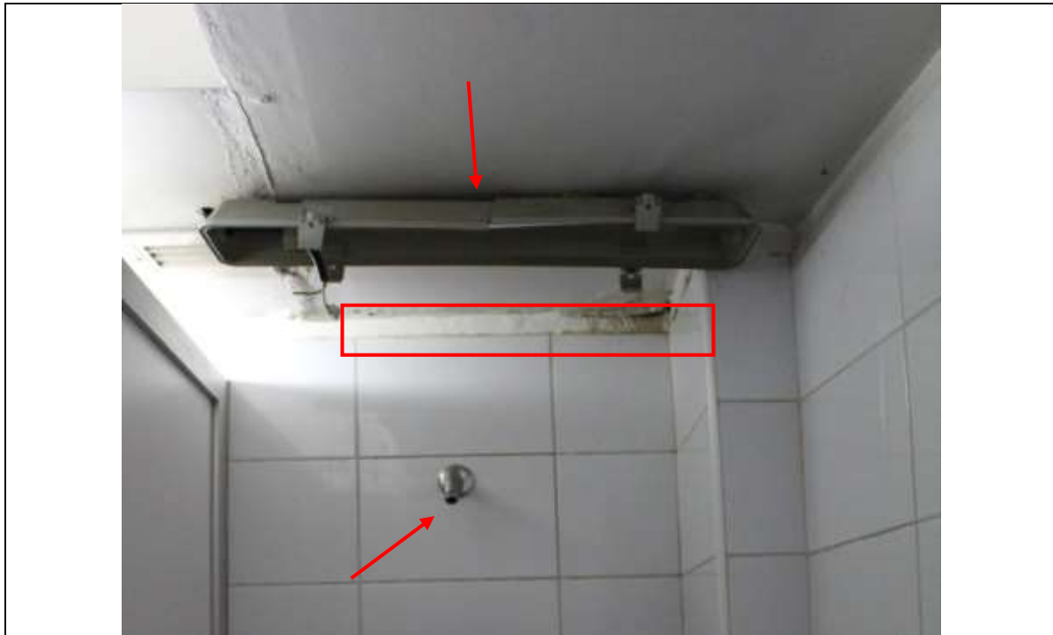
Fotografía N° 3. Piezas faltantes en grifería de ducha y en bandeja de iluminación.
