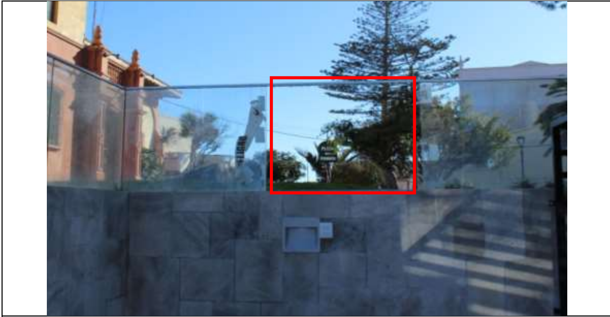
Fotografía N° 25. Pieza faltante de baranda de protección de la caja escala del acceso peatonal oriente del edificio.
