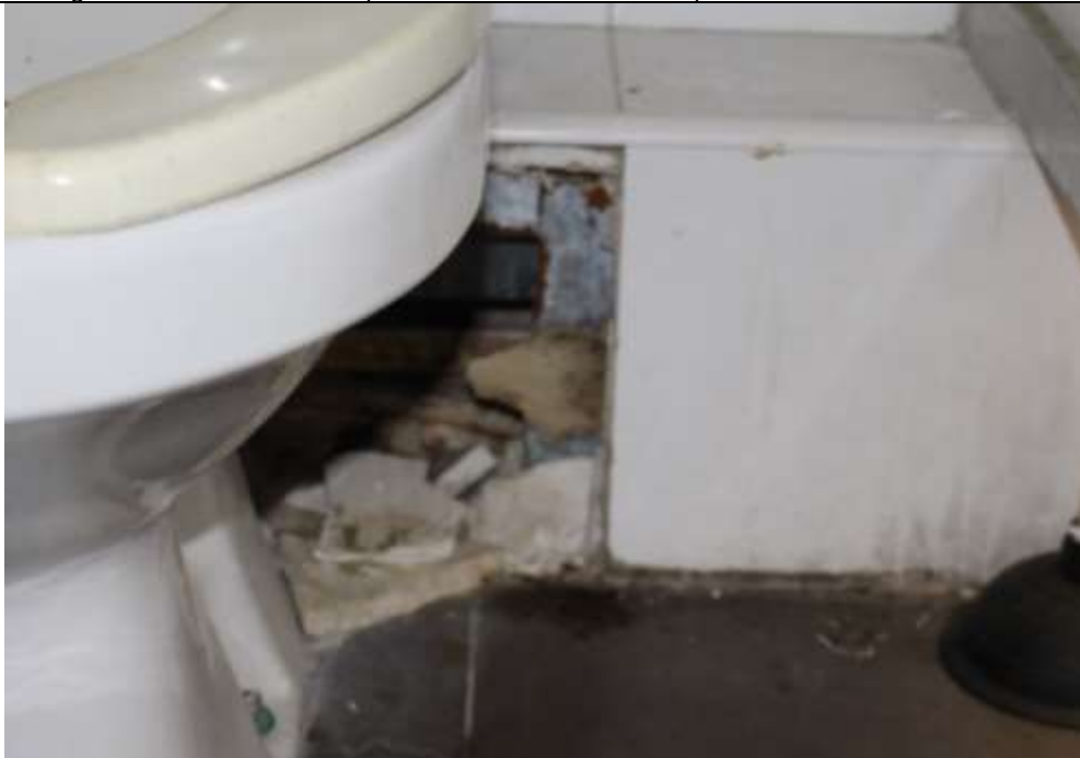
Fotografía N° 8. Baño varones para clientes. Pieza de cerámica desprendida y presencia de corrosión en elemento metálico soportante, sector viga falsa inferior.
