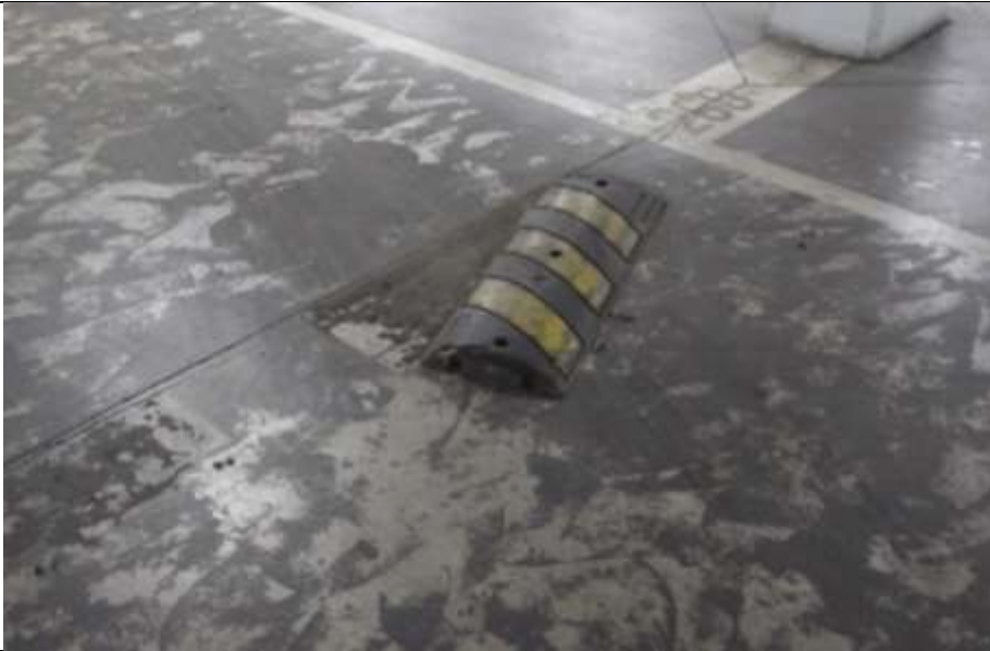
Fotografía N° 21. Resaltos ubicados en sector estacionamiento N° 260 faltante y pieza desprendida.
