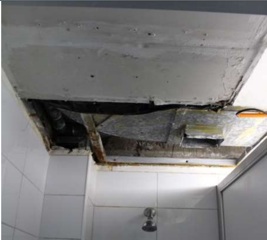
Fotografía N° 5. Baño varones para el personal de la empresa. Cielo deteriorado con pieza desprendida y presencia de corrosión en elementos metálicos soportantes.
