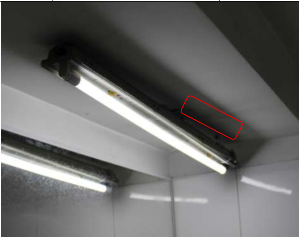
Fotografía N° 6. Baño damas para clientes. Luminaria desprendida frente a espejo.
