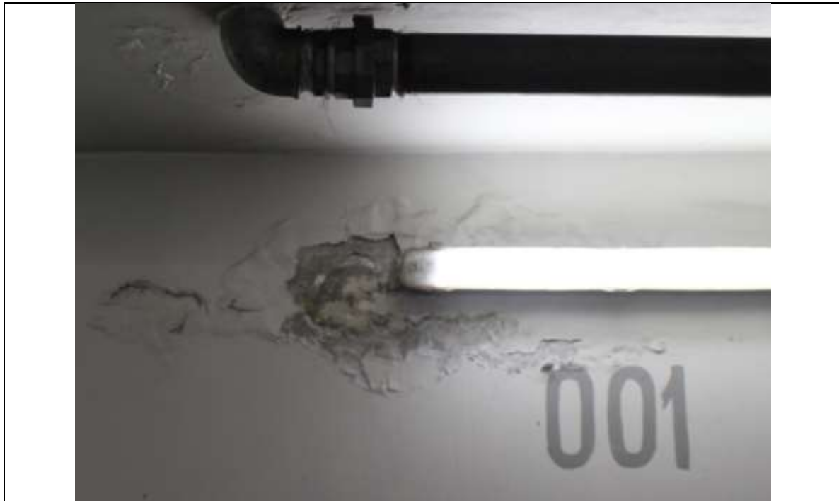
Fotografía N° 11. Presencia de humedad y daño en revestimiento de muro de hormigón y losa, en sector de estacionamiento N° 1.
