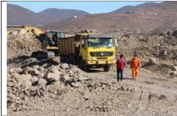
Fotografía N° 13. Extracción y carga de áridos sin autorización, sector Quebrada Santa Gracia.
