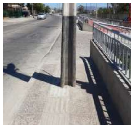
Fotografía N° 12 – 25/07/19: Poste del tendido eléctrico entre las calles Seminario y Los Perales interrumpe la ruta accesible y huella podotáctil.
