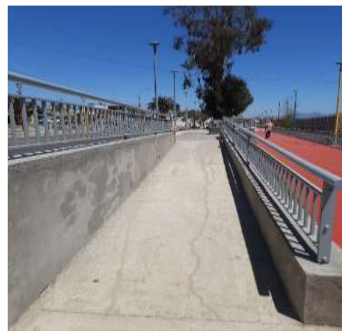
Fotografía N° 10 – 25/07/19: Baranda instalada en la rampa de la esquina con calle Seminario posee solo un pasamano en su parte superior, está ubicada únicamente a un solo costado de la rampa y terminan justo en la entrada y/o salida de esta.
