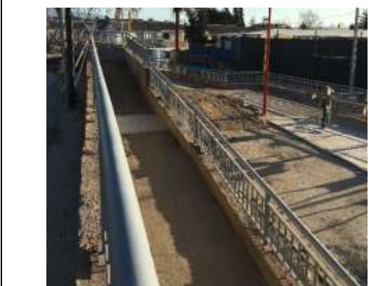
Fotografía N° 11 – 25/07/19: Baranda instalada en la rampa de la esquina con calle Heriberto Valenzuela posee solo un pasamano en su parte superior y está ubicada únicamente a un solo costado de la rampa.
