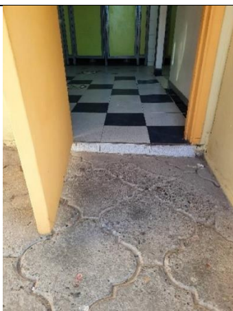
Fotografía N° 7, baño de varones sin rampa.
