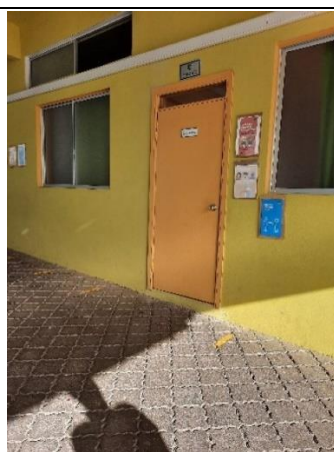
Fotografía N° 8, sala N° 3 sin rampa.
