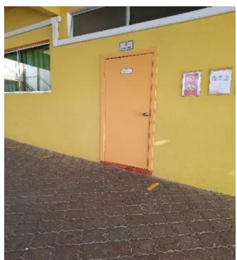
Fotografía N° 9, sala N° 4 sin rampa.
