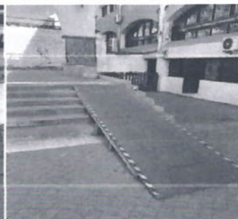
Inadecuada rampa de accesibilidad
