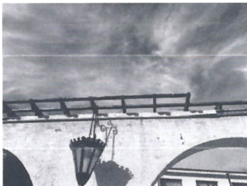
Entramado de madera con elevado grado de deterioro
