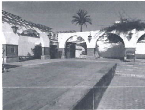
Tarima en inadecuadas condiciones
