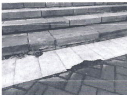
Rotura y desprendimientos en superficie
