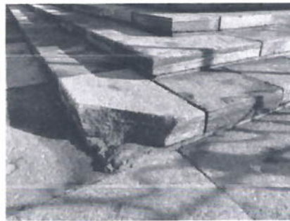
Rotura en piedras calizas
