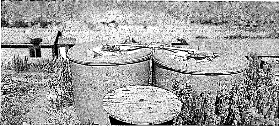
Ilustración 9 Estanques comunitarios, EMR El Chay Bajo
