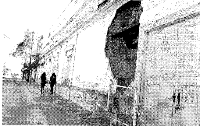
Derrumbe de fachada.
