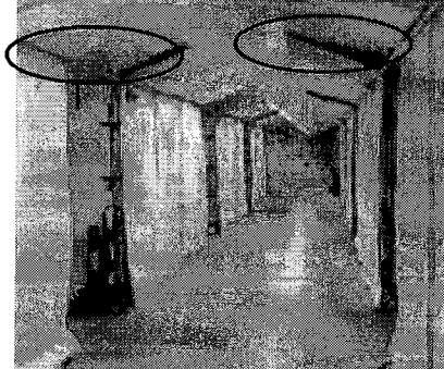
Fotografía N° 10 – 17-08-2020: Sector de intersección del pasillo con módulos de hospitalización sin carpa térmica.
