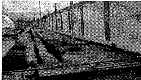
Fotografía N° 14 – 17-08-2020: red de agua potable exterior sobre la superficie y sin protección.
